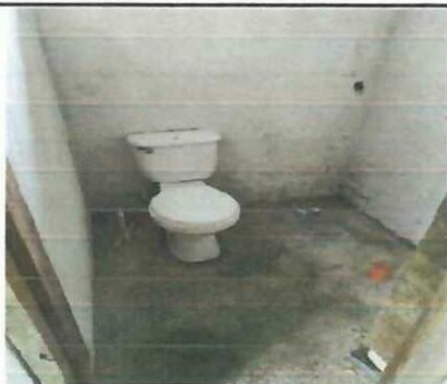
Foto 7: Sustrucción de accesorios de inodoro, debido que no funcionan correctamente.
