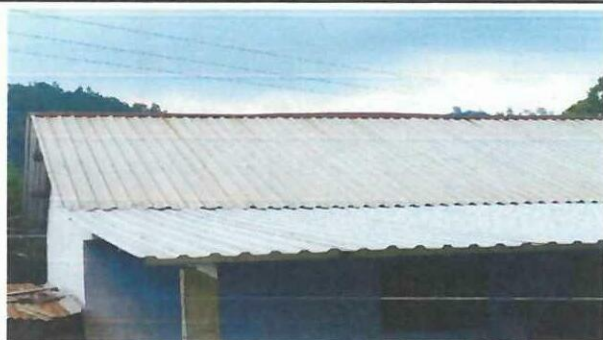
Foto 9: Sustrucción de cubierta de lámina en aulas debido a que la cubierta actual tiene filtraciones de agua.
